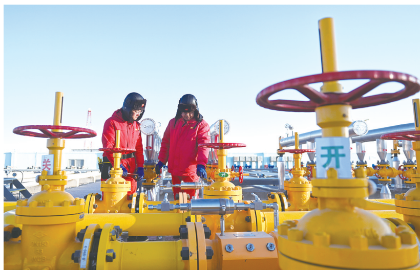
1月26日,在中国石油天然气集团公司青海油田公司采气一厂,工人在检查输气管道。涩北气田地处柴达木盆地东部的戈壁,是“涩—宁—兰”管道的气源地和“西气东输”管道的主要接替气源之一,平均海拔2780米。该气田承担着青海、甘肃、西藏、宁夏四个省区多个城市的供气任务。随着极寒天气到来,为保证民生用气,中国石油天然气集团公司青海油田公司采气一厂的工人们加强安全管理,24小时不停歇保障供气安全。 新华社发
