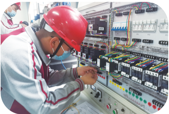
电气安装与调试
