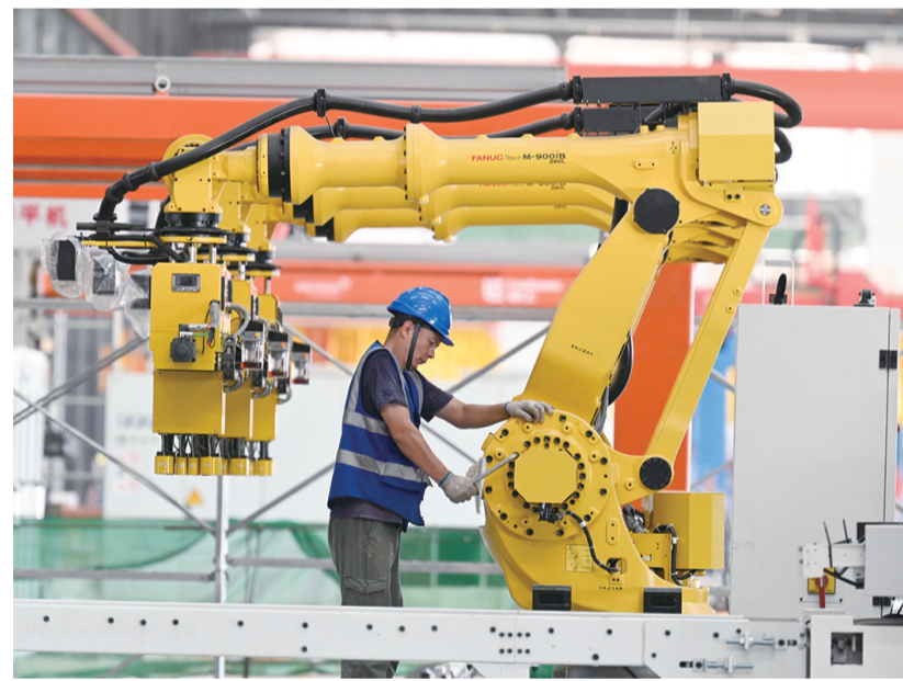
7月24日傍晚,在广西柳州柳工集团柳工装载机灯塔工厂项目工地,工人在车间里调试设备。连日来,广西柳州高温天气持续。在当地重点项目工地,施工单位在做好疫情防控和防暑降温工作的同时,采取“忙两头、歇中间”错峰施工的方式,稳步推进施工进度。 新华社发
