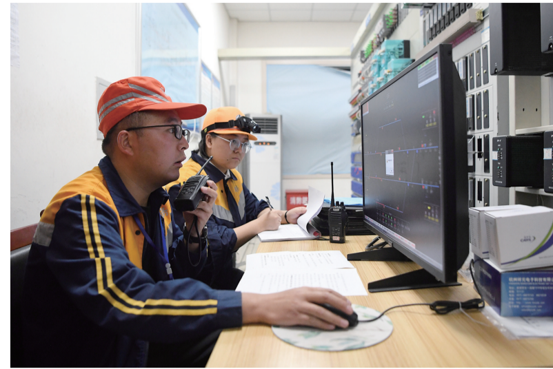
8月25日,嘉峪关电务段工作人员在兰新铁路玉石站作业。当日,由中铁八局电务公司和中国铁路兰州局集团嘉峪关电务段等单位负责施工的兰新铁路玉石站计算机联锁系统升级改造工作顺利完成。据了解,计算机联锁系统作为车站的控制中枢,被称为列车运行的“大脑”,集中控制车站的信号、道岔和轨道区段等信号设备,此次兰新铁路甘肃段共有玉石、高台、山丹等10座车站对“行车大脑”进行升级改造,预计9月15日前全部完工投用,将进一步提升兰新铁路客货运输效率。 新华社发
