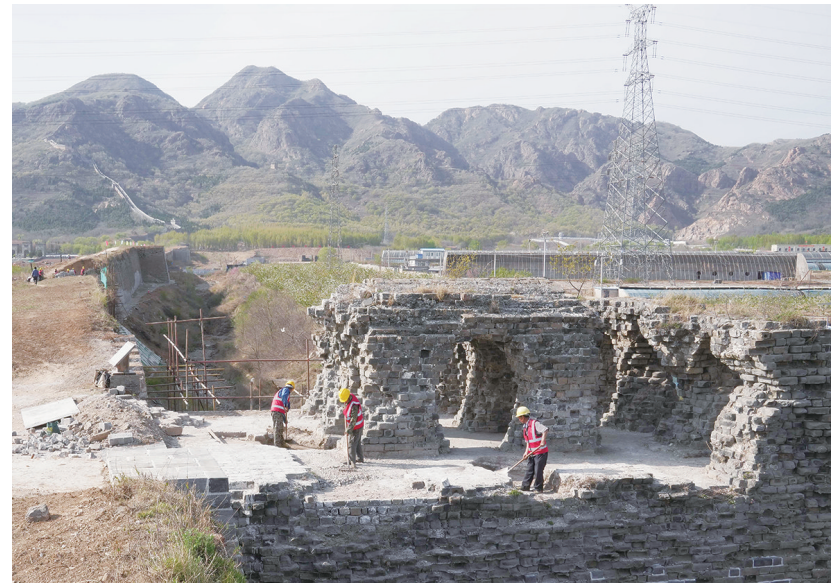
4月19日,工人在山海关长城北翼城修缮工程工地施工。近日,河北省秦皇岛市山海关区山海关长城保护展示工程——北翼城1号马面至4号马面段保护修缮工程施工稳步推进。据介绍,该工程坚持“最小干预”和“不改变原状”的原则,尊重长城各时期的历史的演变,以考古成果为依据,最大限度保留各时期历史信息 and 长城历史风貌。同时,工程采取针对性技术措施,对城墙进行维修和加固,减少墙体拆砌量,加强城墙预防性保护,消除安全隐患。按计划工程将于今年5月竣工。 新华社发
